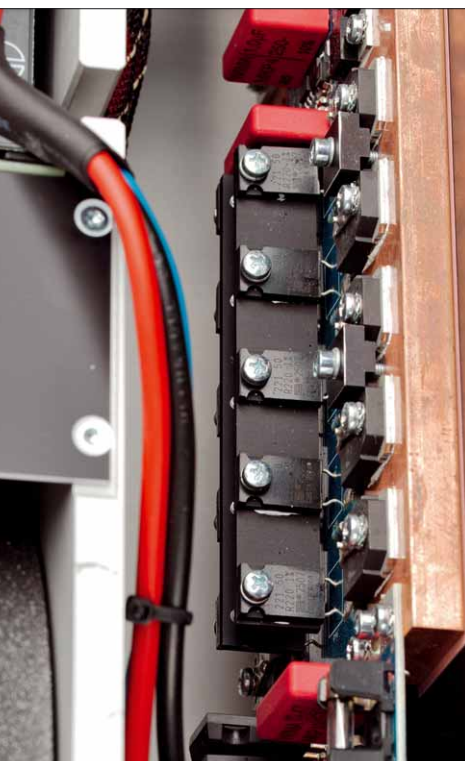
Zweimal fünf Endtransistoren pro Kanal werkeln auf massiven Kupferschienen
